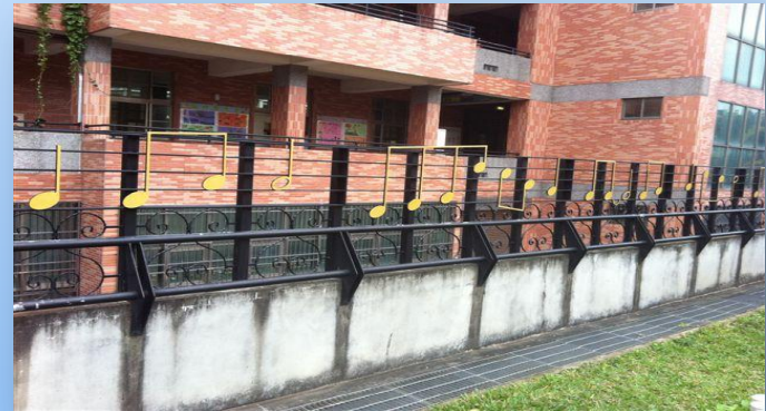
老舊污損矮牆 與校園景觀無法融合
